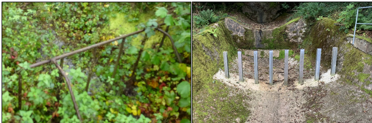
Abbildung 77: Bestehender Rechen Wilsecker Bach und zu empfehlende Alternative
