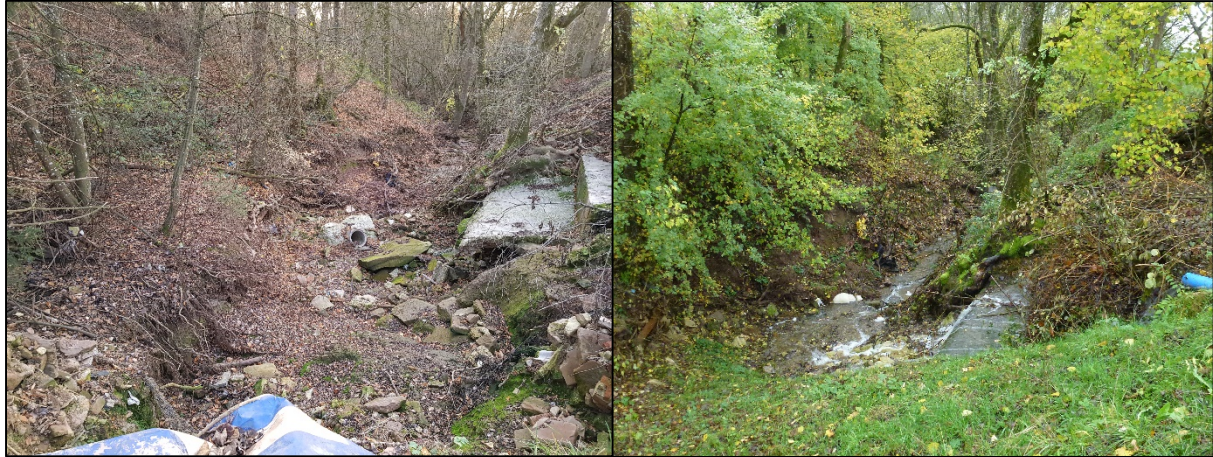
Abbildung 91: Starke Ufer- und Sohlerosion , Starkregen 2018
