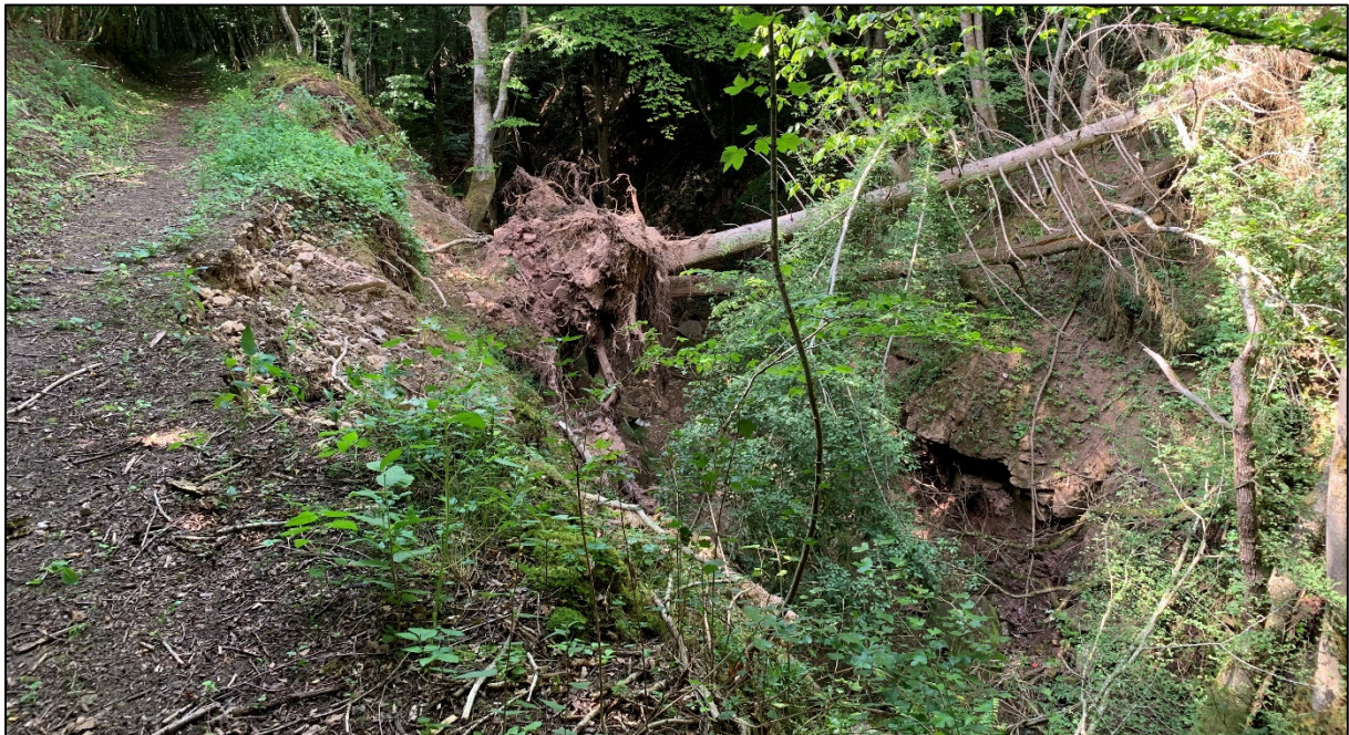
Abbildung 39: Umgestürzte Bäume und abrutschende Böschung Schienengraben, Sommer 2020
