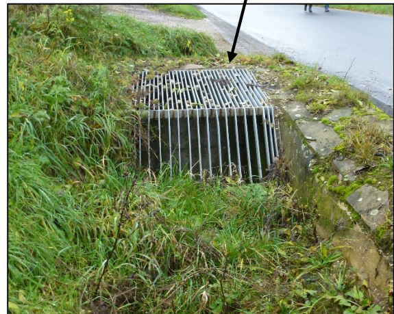
Abbildung 41: Entwässerung Bademer Straße, Rost Einlaufbauwerk
