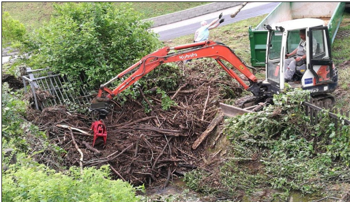
Abbildung 78: Räumungsaktion verlandetes Einlaufgitter nach den Starkregenereignissen 2018, Situation Zufahrt
