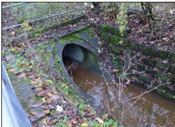
Abbildung 29: Verrohrung Wilsecker Bach
