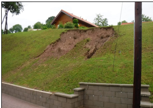
Abbildung 9: Hangrutsch, kürzlich eingesäte Grünfläche unterhalb Kirchstraße 6
