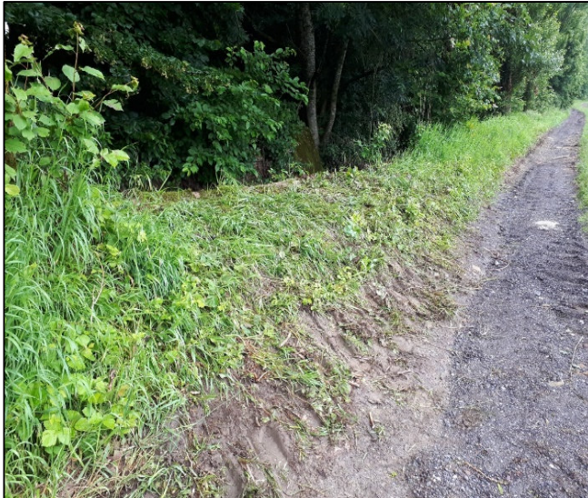
Abbildung 44: Wirtschaftsweg "Hiel" mit Auswaschungen infolge der Unwetter 2018
