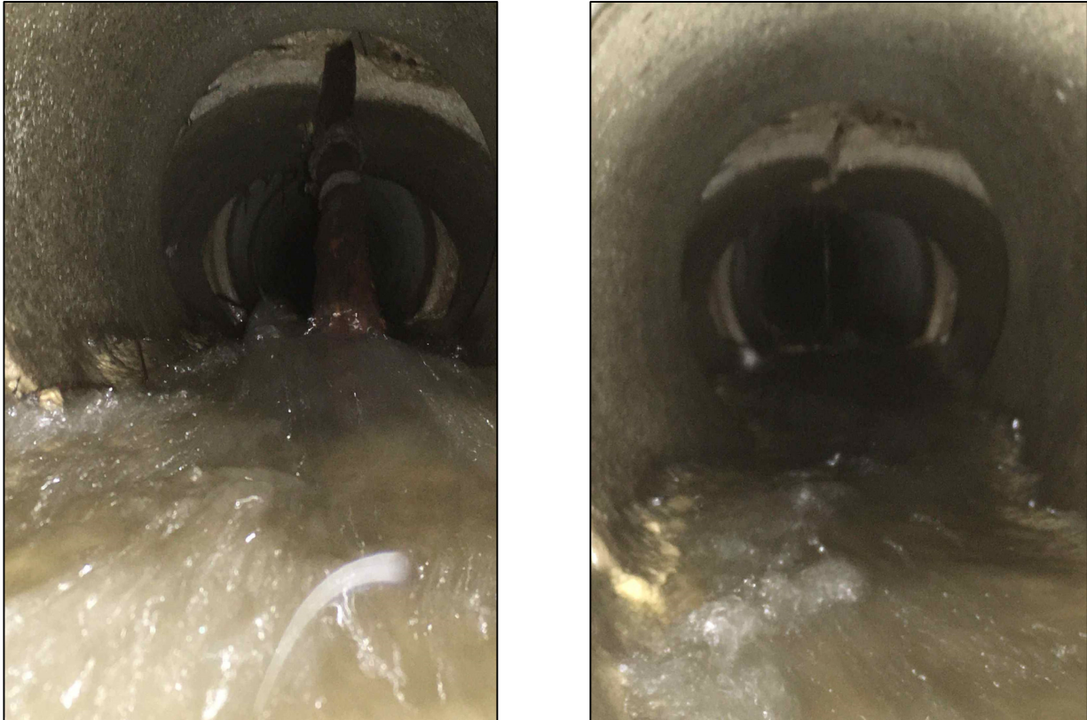
Abbildung 42: Zustandsbilder Verrohrung Tiefbach
