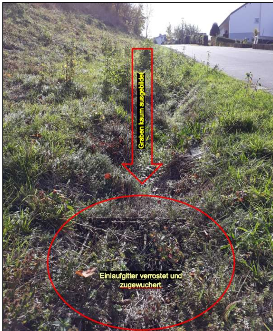
Abbildung 16: Zustand Einlauf und Graben bei "Kuhweg 4"
