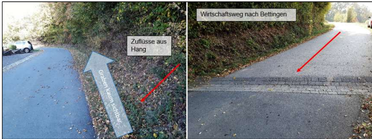
Abbildung 15: Abflusssituation "Kuhweg 16 bis 18"
