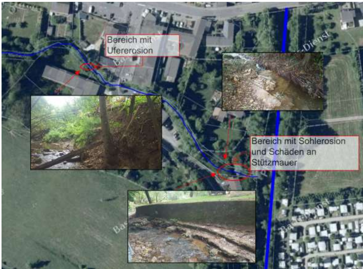
Abbildung 13: Schäden am Nierbach - Lage und Umfang
