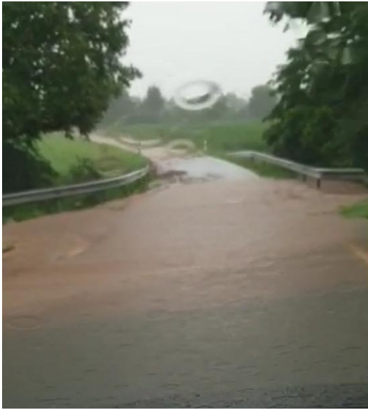
Abbildung 1: Brückenbauwerk Weilerbach - Kyllburger Straße, Überflutung durch Extremwetterereignis vom 14.07.2021. Quelle: Ortsgemeinde Kyllburgweiler
