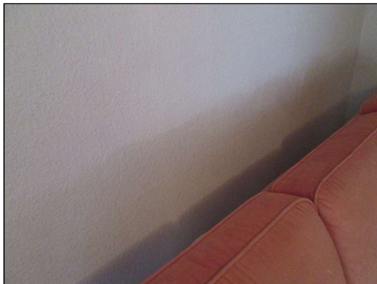
Abbildung 5: Schaden an Mauerwerk "Brückenstr. 3" von innen
