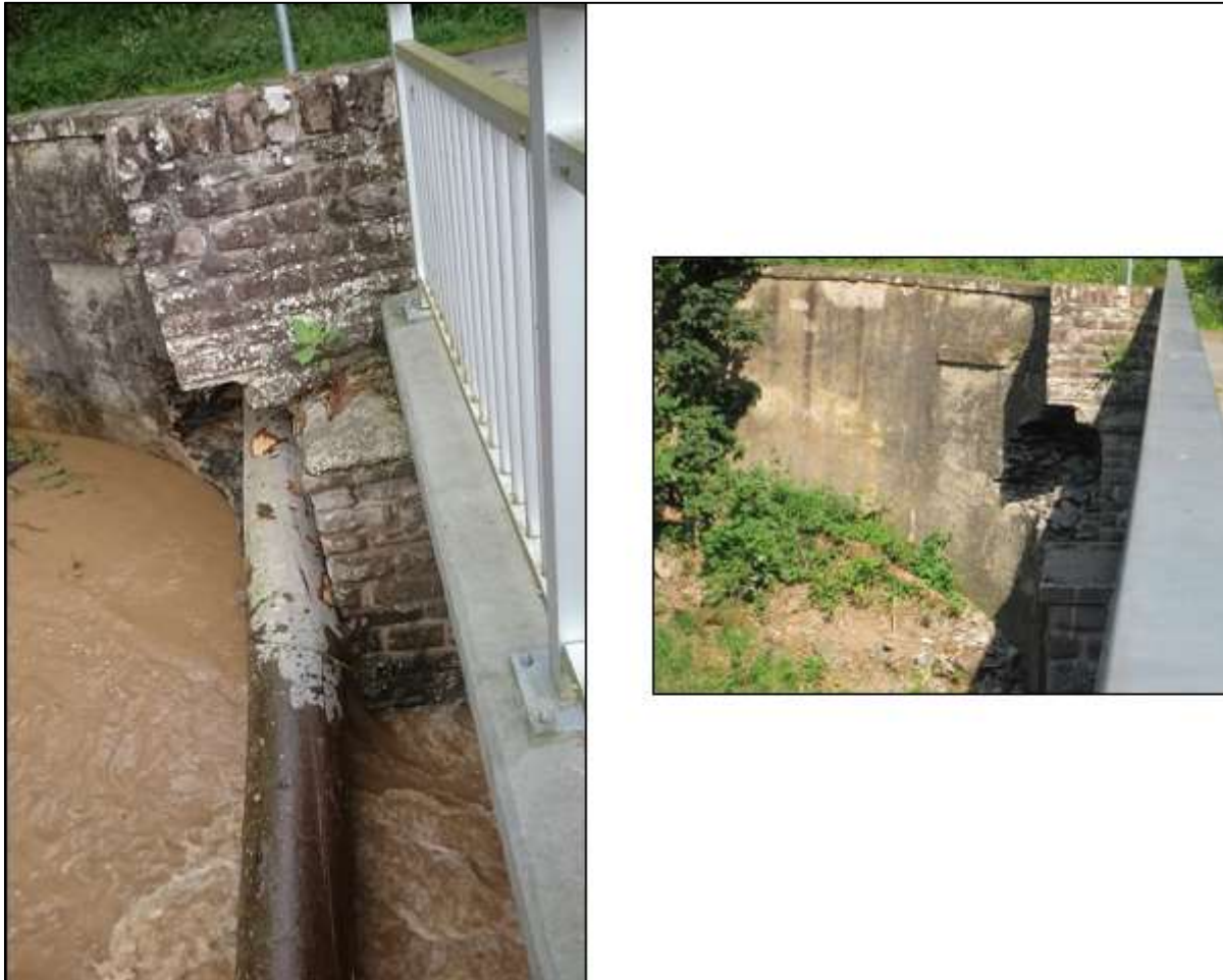
Abbildung 10: Schaden an Prümbrücke in Echtershausen
