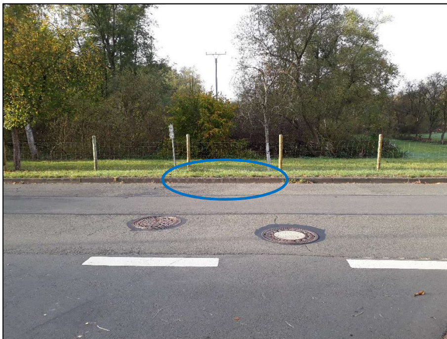
Abbildung 28: Notwasserweg "In der Ai" - Bordsteine öffnen in der Bitburger Straße
