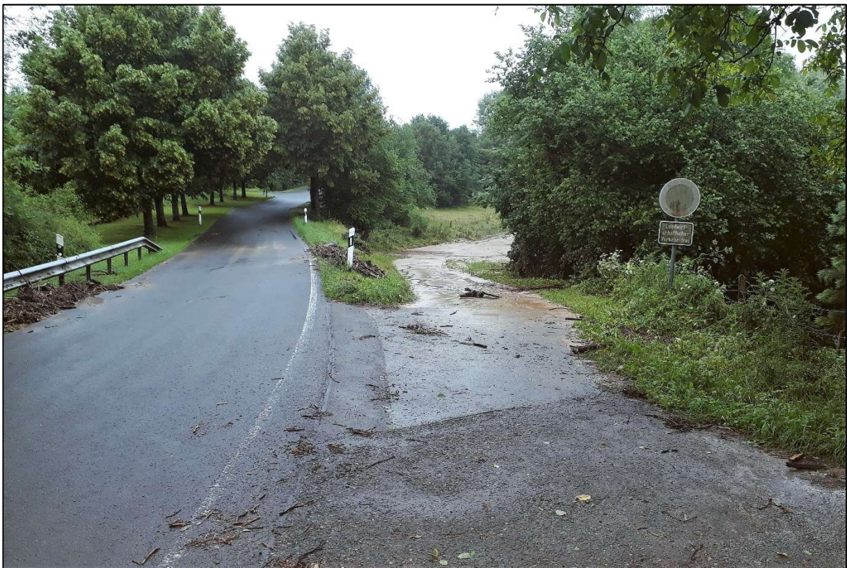
Abbildung 25: Geflutete Senke am Durchlass durch die K72
